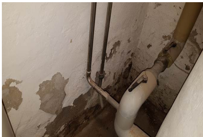
Foto 16: Enkelte uisolerede rør i varmecentral, nr. 16 i kælder.
