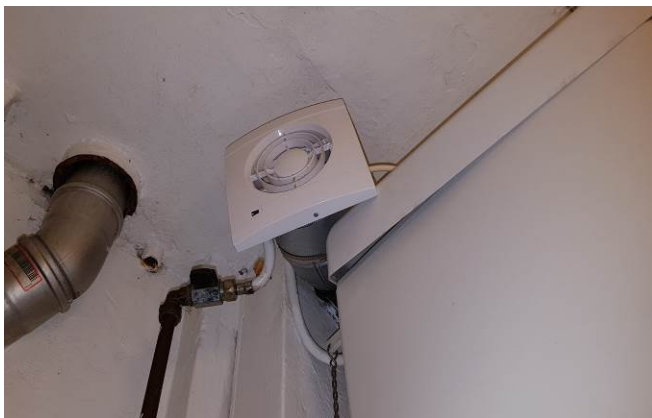
Foto 21: Aftræk tilsluttet eksisterende kanal nr. 16, 2 tv.
