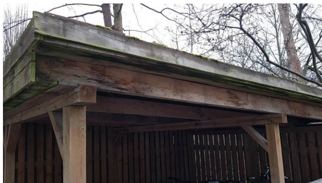
Foto 2: Nedslidte vindskeder ved skur
