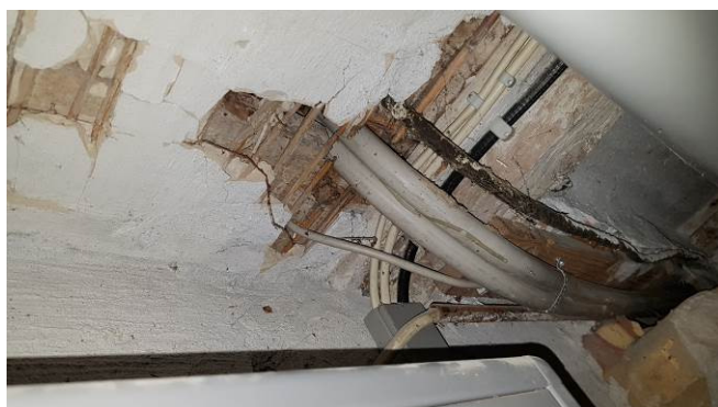
Foto 3: Manglende brandsikring i kælder mod stueetage, flere steder.
