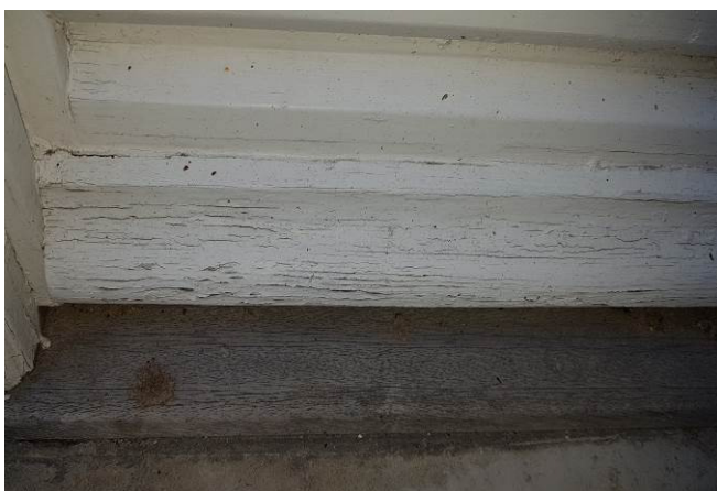
Foto 11: Begyndende slid i overfladebehandling på hoveddør nr. 16.
