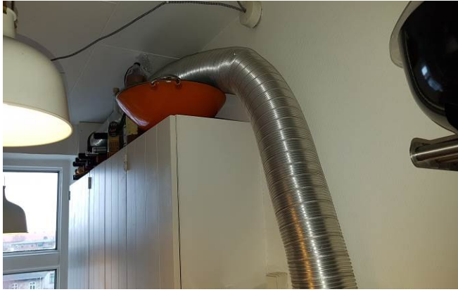
Foto 22: Aftræk ført ud i facaden nr. 14, 4 th.
