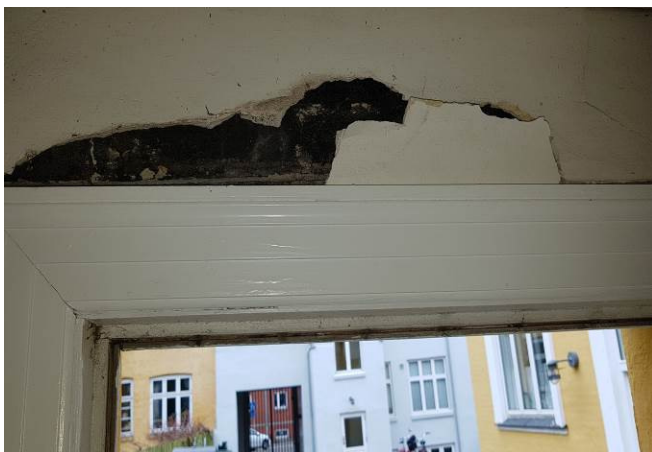
Foto 25: Revne over hoveddør i vaskeri.
