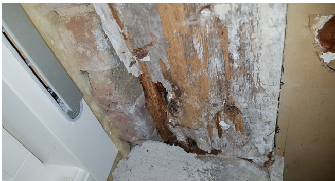
Foto 6: Nedbrudt overligger i kælder baghus, i rum med udslagsvask.
