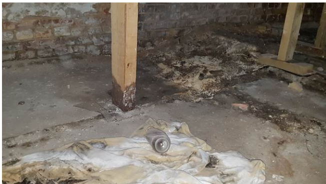
Foto 14: Understøtning til hovedtrappe med fugtskade i nr. 14, alle trapper kontrolleres.
