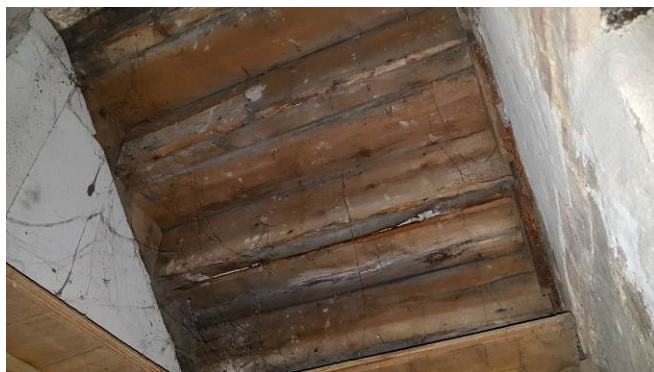
Foto 13: Manglende brandsikring på under- side af hovedtrappe i kælder, alle trapper.
