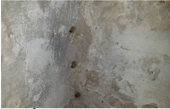
Foto 5: Åbne huller generelt i kældervæg, alle kældre.
