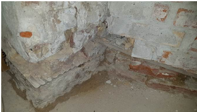
Foto 7: Knuste mursten efter indbankning af fugtspærre, alle kældre.
