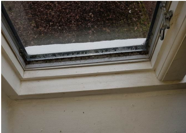
Foto 10: Kondens og skimmel på vinduer i bagtrapper, generelt.
