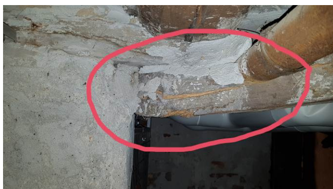
Foto 4: Flækket bærende bjælke med svækket bæreevne i kælder nr. 16.
