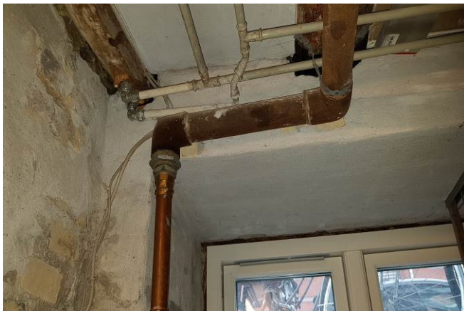
Foto 20: Ved udskiftning af gasrør er der brugt andre type rør og dimensioner i kælderen under nr. 16.
