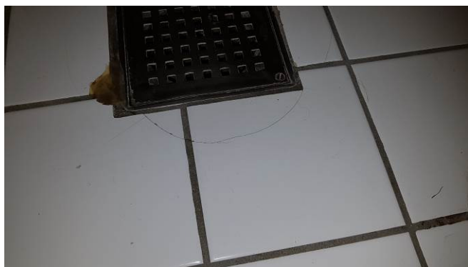
Foto 15: Revnet/utæt gulv i bruseniche i nr. 16, 2 tv.
