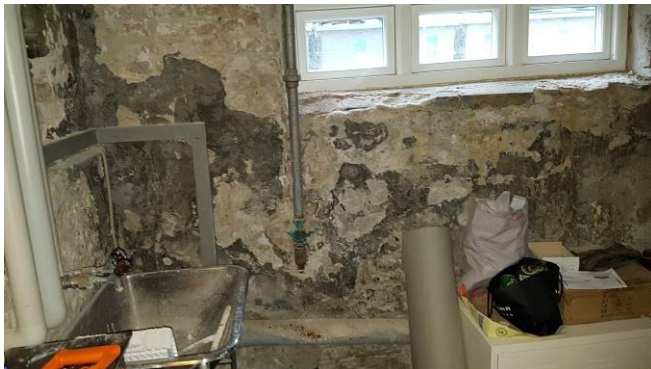
Foto 8: Fugt på kældervæg i baghus.
