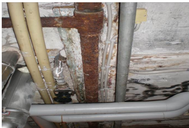
Foto 19: Rustne gasrør i kælder, generelt.
