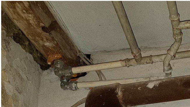
Foto 17: Rør ført igennem bærende bjælke i kælder under nr. 16.
