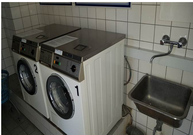
Foto 24: Vaskemaskiner med alment slid i vaskeri.
