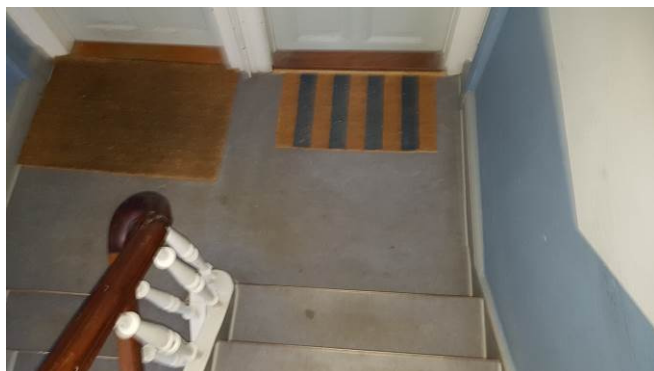
Foto 12: Begyndende slid i overflader på hovedtrapper, generelt.
